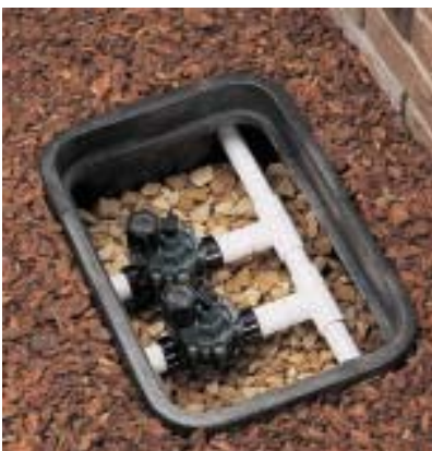
Zwei Ventile in einem Ventilkasten. ©2006 Rain Bird Corp.
